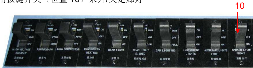
图 57: 机械间灯扳键开关的位置
